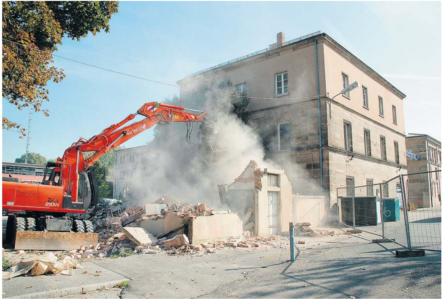
Mit dem Abbruch des alten Trafohäuschens neben dem ehemaligen Evenord-Gebäude haben gestern Vormittag die Vorbereitungen zur Errichtung des Elektromarktes Saturn am Kulturforum Fürth begonnen. Foto: Marianne Vordermayr
