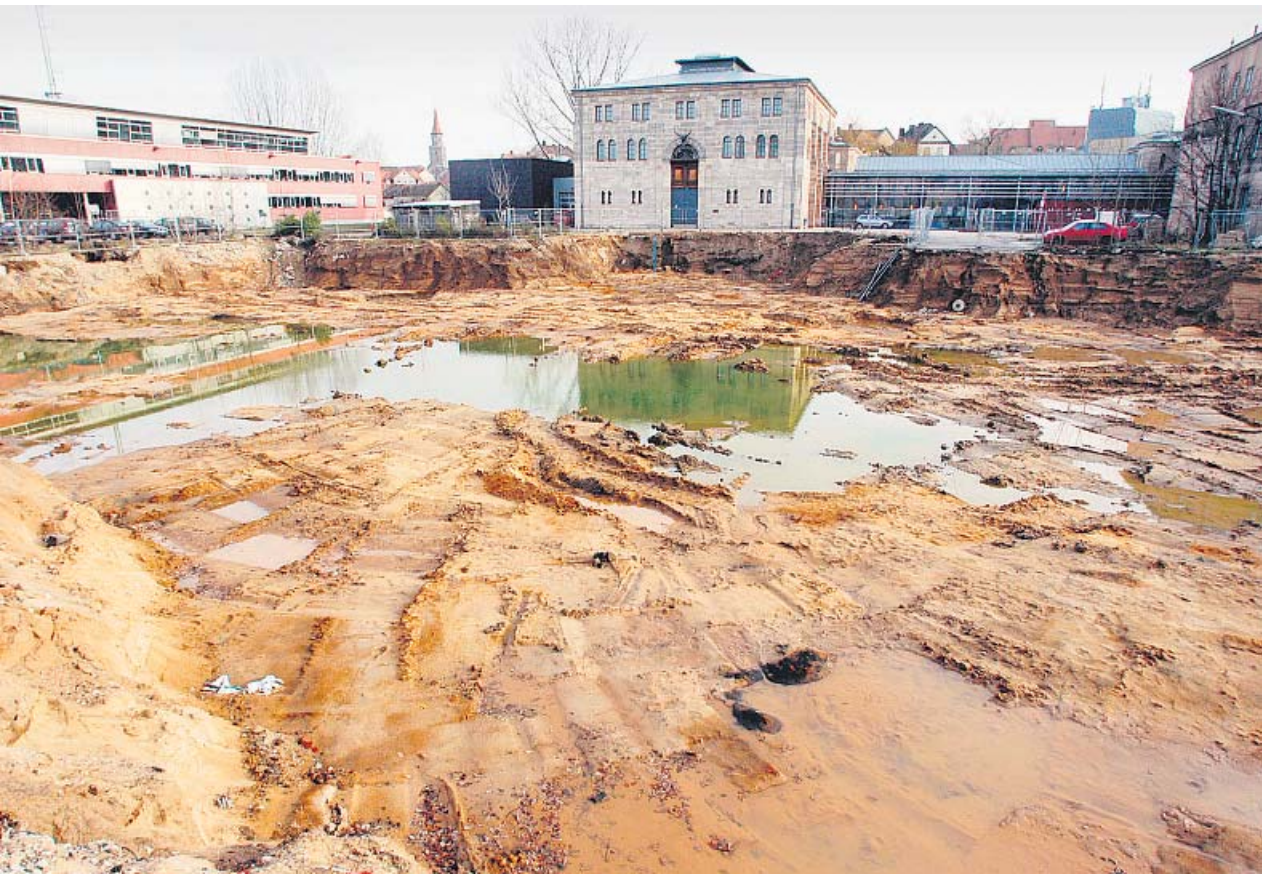
In spätestens drei Wochen soll nach Angaben des Architekten auf der Saturn-Baustelle an der Kapellenstraße wieder gearbeitet werden. Probleme bereitet der sehr feuchte Untergrund. Foto: Hans-Joachim Winckler
